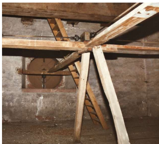
Transmission du mouvement vers les cadrans Niveau 2 - Clocher de l'église de Reichshoffen
