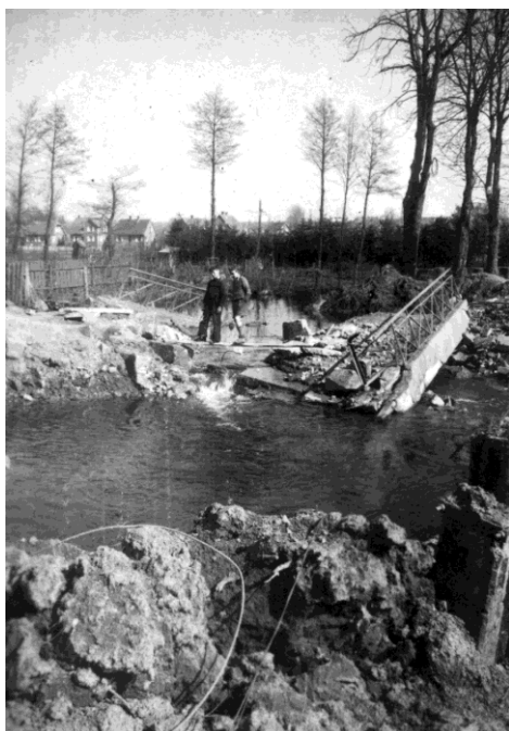
Destruction du pont sur le Schwarzbach rue des Cuirassiers à Reichshoffen.
